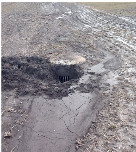
Bilde 30: Dårlige innløpsrister går for tett av halm, kvist eller jord.
