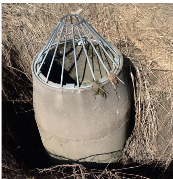
Bilde 9a og 9b: Betongkummer har utette skjøter, og er svært utsatt for erosjon på utsiden av kumveggen. Etter hvert utvikler dette seg til et karter rundt kummen.
