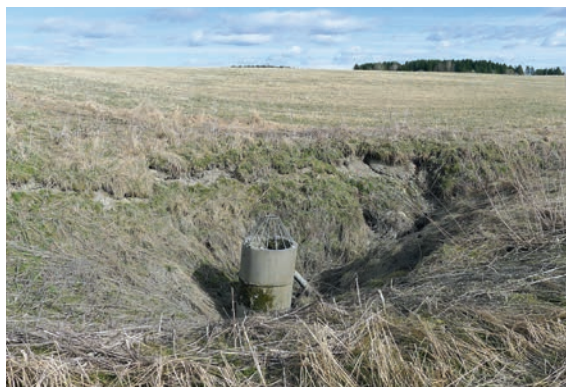
Bilde 27: Erosjonen rundt kummene kan være så kraftig at kummene står igjen som en pipe i et erosjonskrater.
