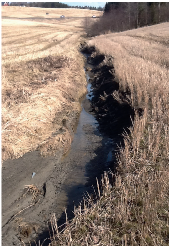
Bilde 22: Tett innløp eller for dårlig dimensjon kan føre til at vannet renner over og eroderer over rørledningen.
