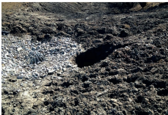
Bilde 29: Det er viktig at overflatelaget er tett, ellers fortsetter bare erosjonen. Dette er et eksempel på en reparasjon som ikke er vellykket.
