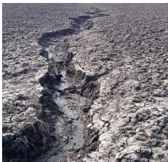
Bilde 6a og 6b: Mange dråg har årlige erosjonsskader.
