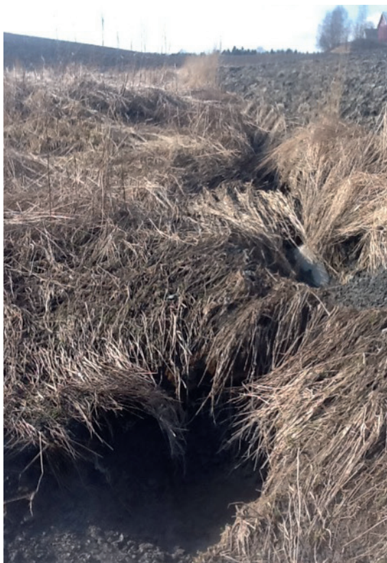
Bilde 23: I grunne anlegg kan hele området over rørledningen kollapse.
