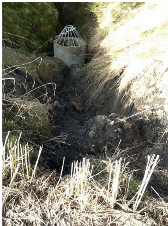
Bilde 28: Ved lekkasjer rundt kummer kan også rørledningen bli skadet, slik at det blir ytterligere erosjon langs rørledningen.
